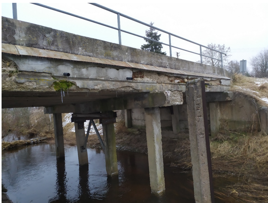
7 pav. Kraštinės plokštės apsamojusios, drėgsta
