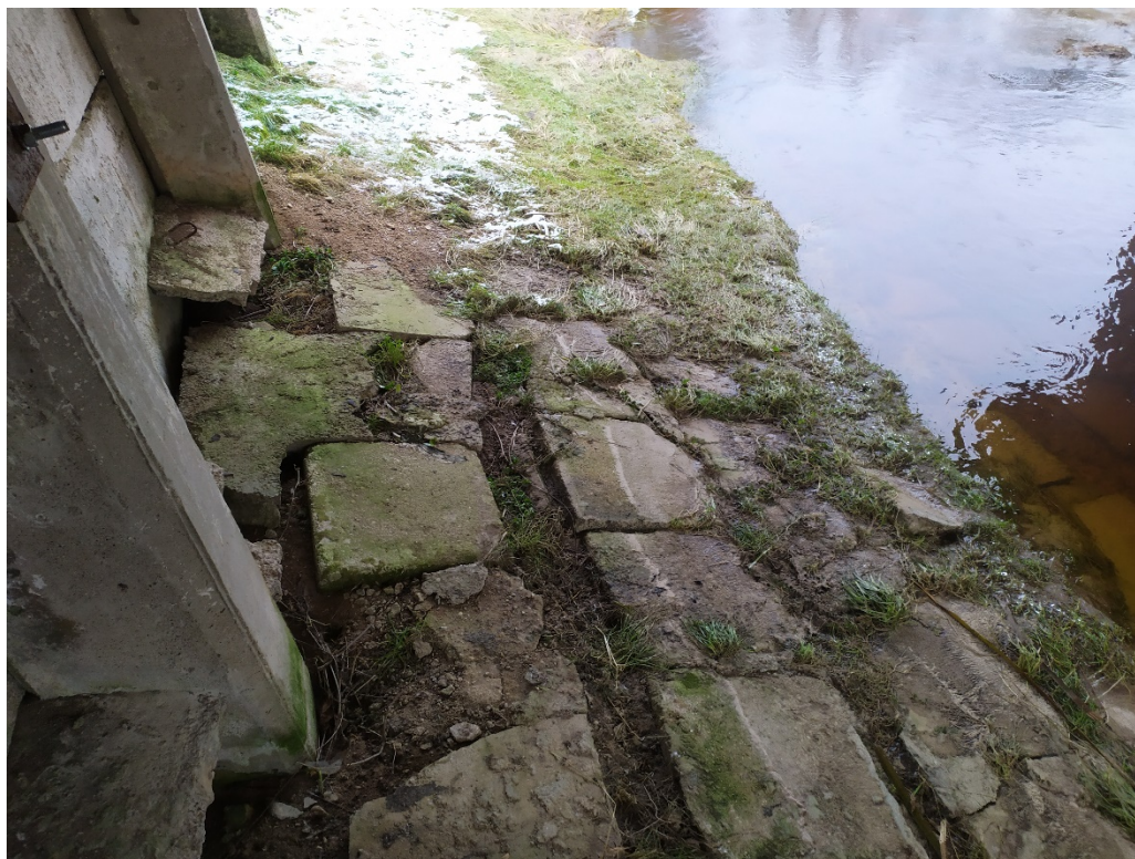
10 pav. Pažeistas kūgių tvirtiniams
