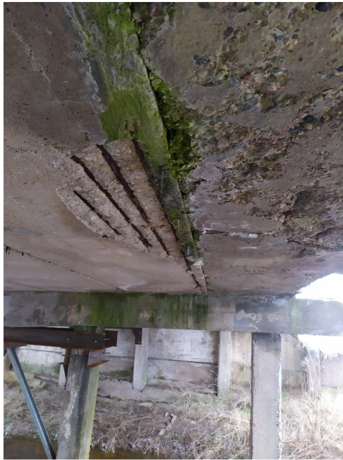
8 pav. Perdangos plokščių pažaidos
