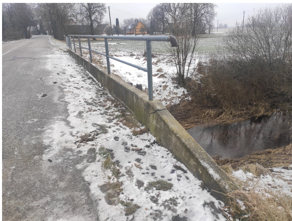
5 pav. Tilto turėklai be vertikalaus užpildo, atitvarai per žemi, auga žolė.
